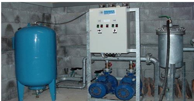
◀ Pumpenanlage im Pumpenhauskeller
