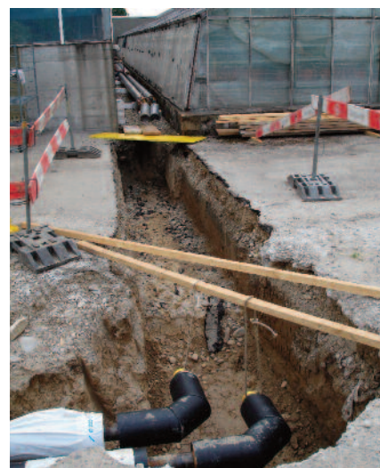
Der Anschluss an das Fernwärmenetz ist eine von vielen Massnahmen bei der Wyss Samen und Pflanzen AG.
